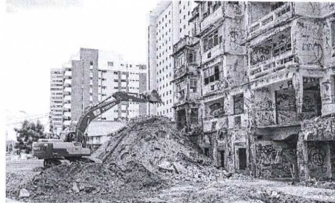
APÓS 12 dias de embargo, a obra de demolição do São Pedro recomeçará
